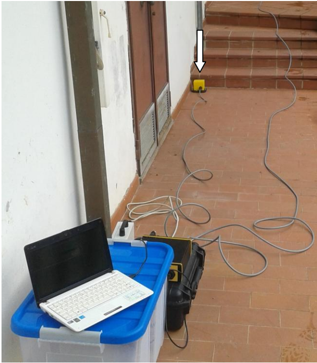
Esempio di monitoraggio tramite Dymas-24 collegato a PC e posizionamento del primo velocimetro Veloget 3D al piano di fondazione di un edificio residenziale
