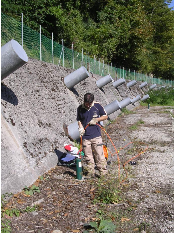
Misure inclinometriche sui versanti del lago artificiale di Vagli (LU)
